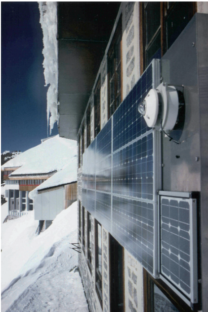
Le Laboratoire photovoltaïque surveille le fonctionnement de l'installation du Jungfrauoch depuis 1993; les résultats des mesures sont enregistrés en continu depuis cette date. Les modules solaires de cette installation raccordée au réseau sont fixés à la façade de la station de recherche de haute montagne. (Source: PV-Labor)
